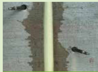
bildet Schaum in feuchten Rissen
