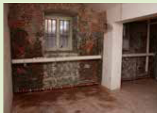
bei feuchtem Mauerwerk
