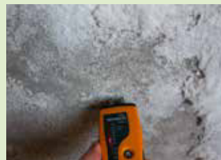
bei salzbelastetem Mauerwerk
