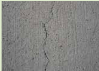
dringt in feinste Risse ein
