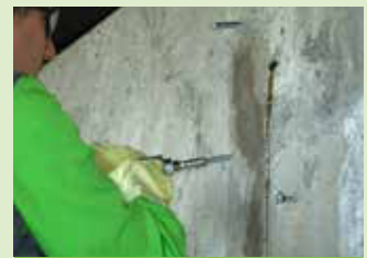
bildet Harz in trockenen Rissen
