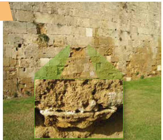
Salzschiäden durch aufsteigende Feuchtigkeit
