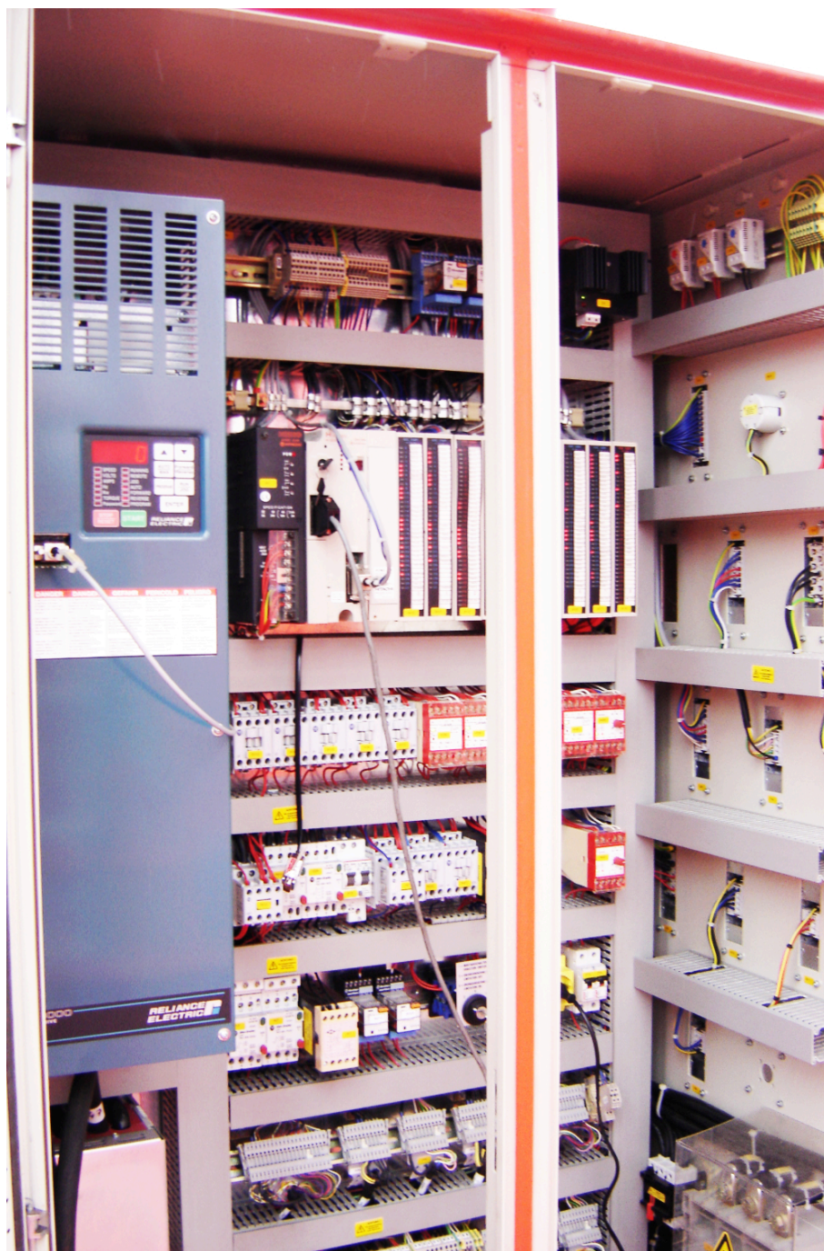
Schaltschrank eines Wolff mit der CC 90 (oben) im herausragenden Gehäuse (Foto Wolff, Archiv P. Meyer)
