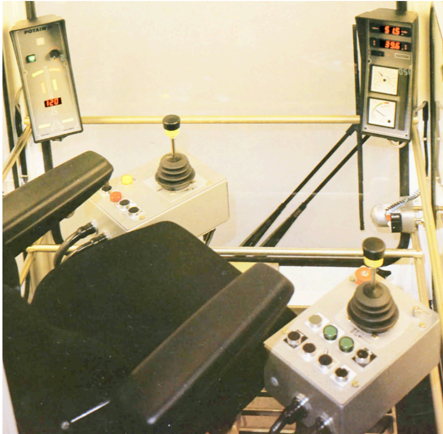
Eine Kabine eines Turmdrehkrans mit Matic (Foto Potain, Archiv P. Meyer)
