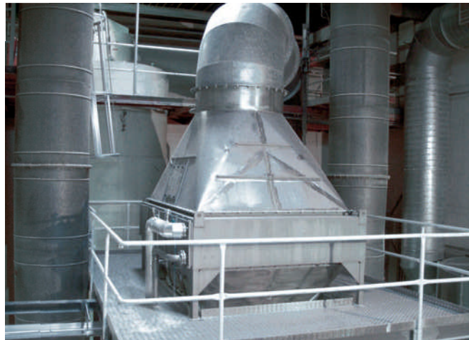
Abluft-Wärmetauscher, integriert in bestehendes Abluftsystem
