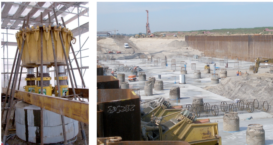
Abb. 4: Pfahlprobekbelastung zur Ermittlung des Last-Setzungs-Verhaltens der Pfähle einer KPP Quelle: Brückner Grundbau
