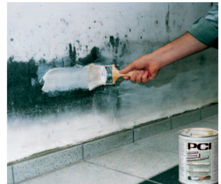
Auftragen von PCI Entöler-Paste auf einen verölten Untergrund, hier auf einen verölten Wandbereich aufgrund eines Hochwasserschadens.
