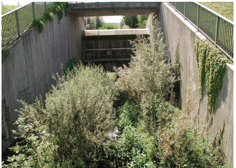
Abb. 6 Bewuchs im Durchlassbereich des Rückhaltebeckens Stadtseebach. (Aufn.: KAISER).
