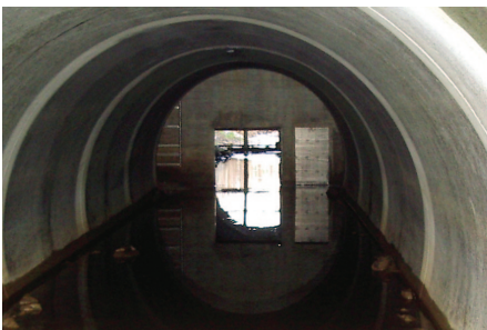
Abb. 4 Rohrdurchlass am Insensbach. Steuer- und Notschieber bilden kein Hindernis. Die Steinsohle bietet ausreichend Habitate (Aufn.: MEIER).
