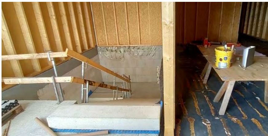
Die Baustelle heute: Das Treppenhaus hat Wände und ein Dach, im Obergeschoss beginnt nun der Ausbau. Foto: Lohmann
