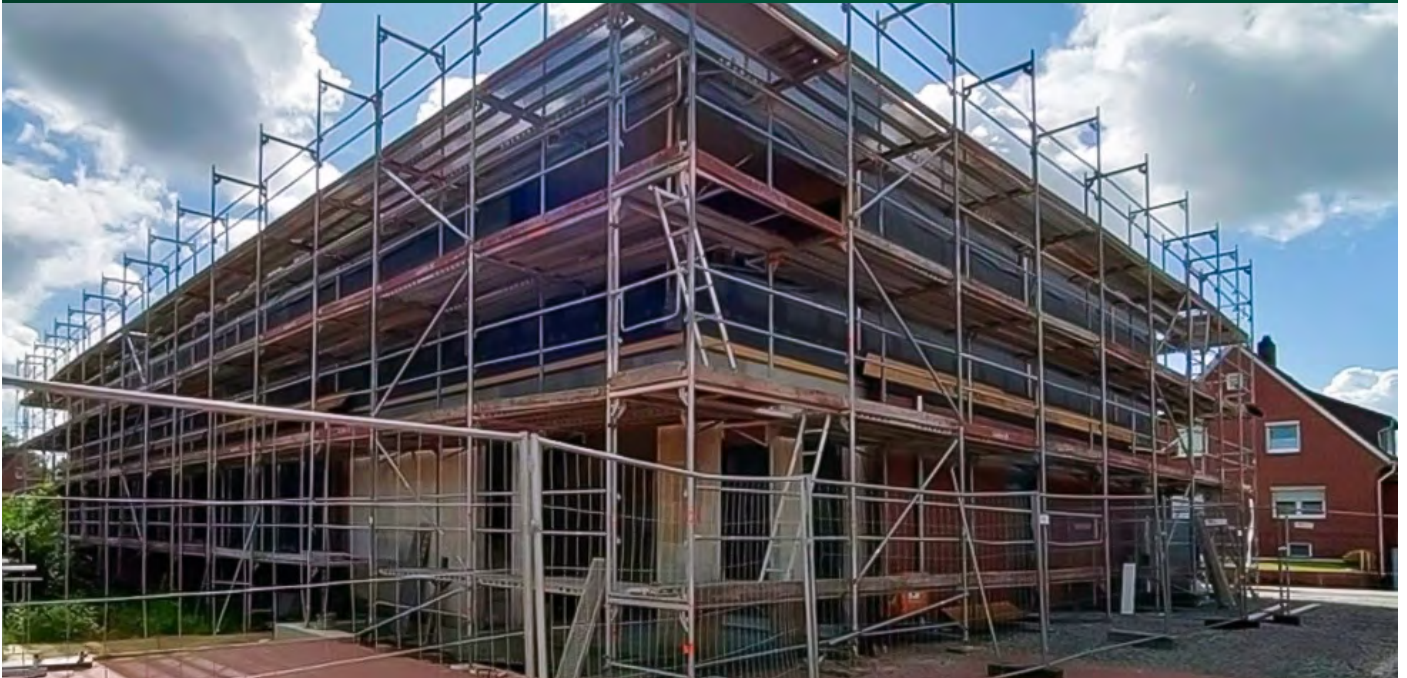
Baustelle an der Oberschule in den Ferien: Vor einem Jahr wurde das ebenerdige Flachdachgebäude neben der Mensa (rechts) gebaut, jetzt wird der Neubau aufgestockt. Foto: Lohmann
