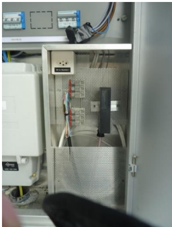
BEP im Zähler-Aussenkasten
