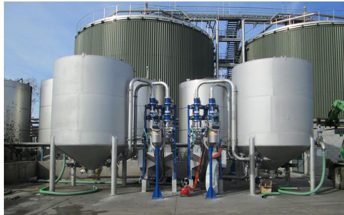
Eine Anlage in Italien mit 4 Stück Hygienisierungsbehälter und der Feinabscheidung von Schwerstoffen mit dem Hydrozyklon.
