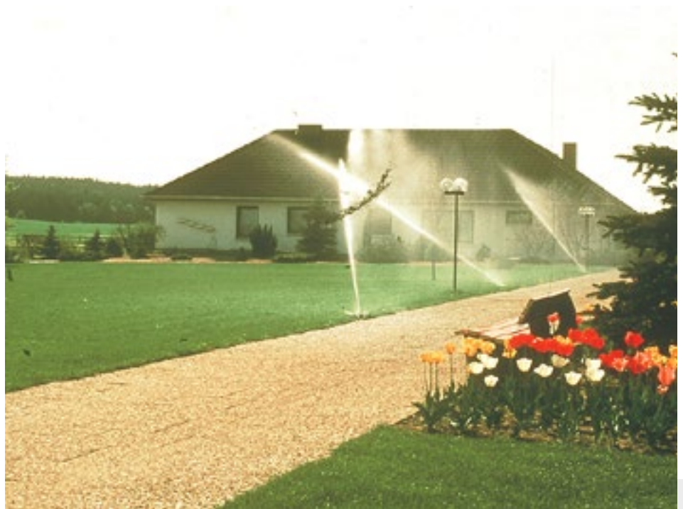
Bild 37: Eine automatische, computergesteuerte Bewässerungsanlage erlaubt eine Beregnung zum optimalen Zeitpunkt.
