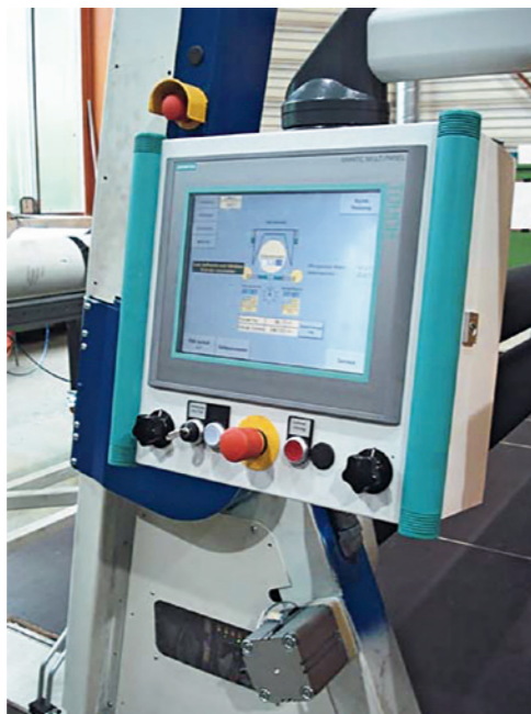
Bedienpanel der Anlagensteuerung
