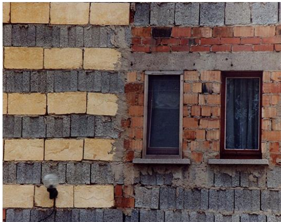
Bild 10-10: Beispiel für nicht empfohlenes Mischmauerwerk
