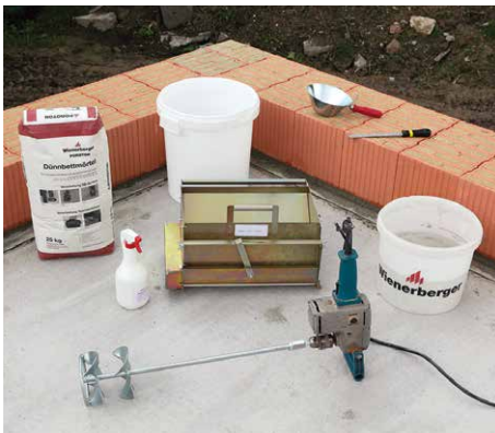
3. Material (gem. Wienerberger Produktprogramm): Dünnbettmörtel, Reinigungsspray (Trennmittel), Anrühreimer, VD-Mörtelrolle, Wassereimer, Doppel-Rührquirl, Schöpfkelle, Feile.
