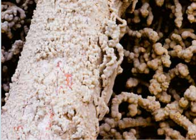
Inkrustation im Eiltempo – Salzablagerungen an Reisigbündeln und Holzbalken des Gradierwerks in Bad Kösen.
