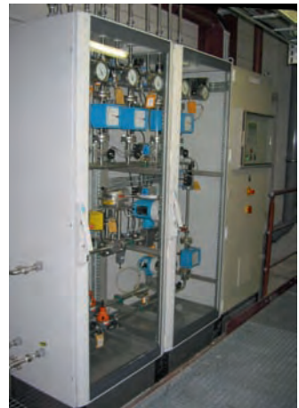
Bild 10: Misch- und Messmodul mit MSR-Schrank für Ammoniakwasser
