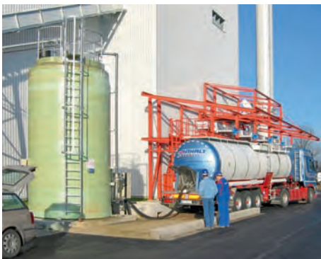
Bild 4: Lagertank für Harnstofflösung
