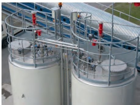
Bild 7: Lagerbehälter für Ammoniakwasser
