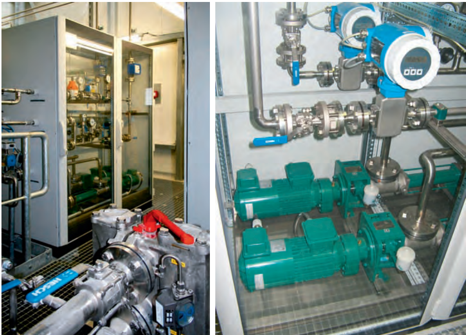
Bild 8: Misch- und Messmodul mit Transferpumpen für Drehrohröfen
