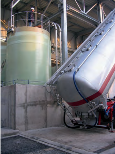
Bild 5: Anmischstation und Lagertank für Harnstofflösung
