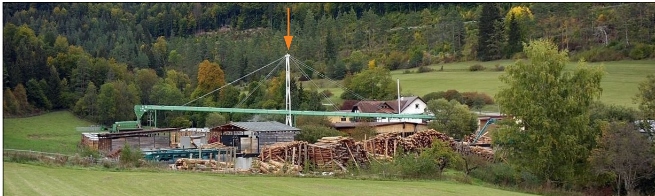
Ansicht auf die bereits errichtete Förderanlage für ein Restholzentsorgung
