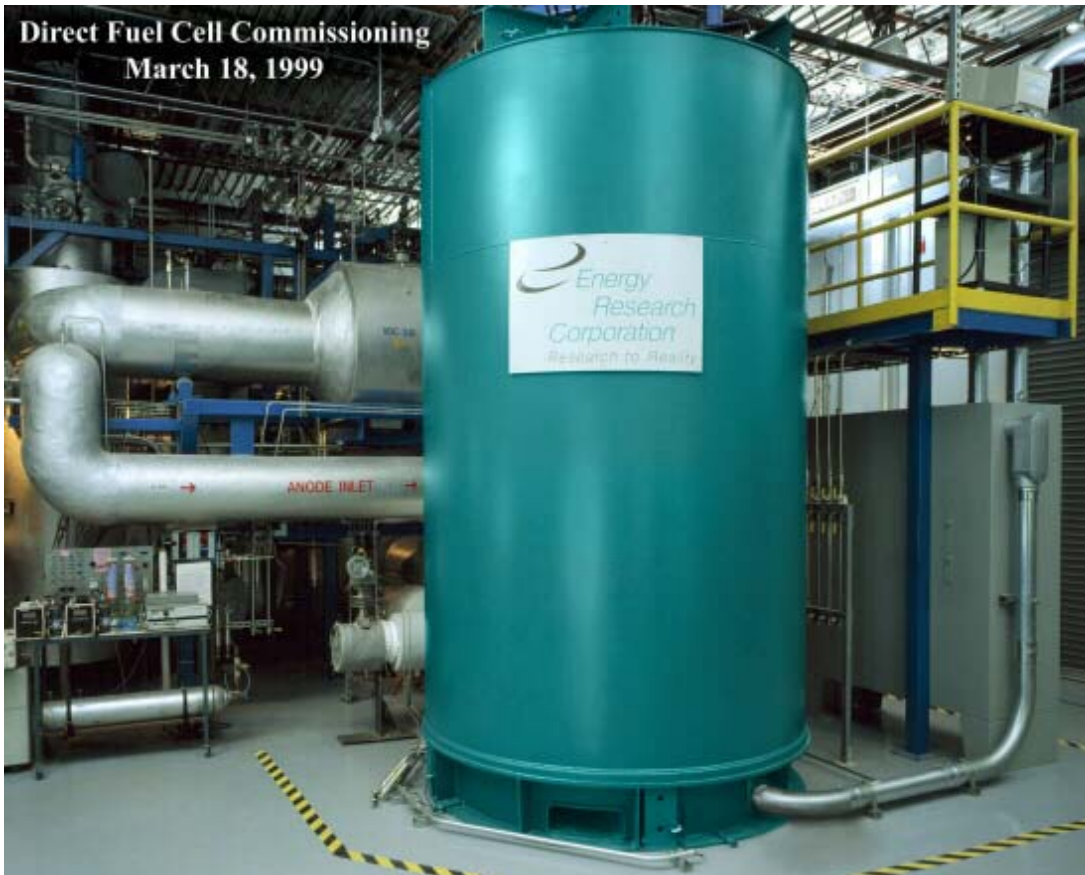
Abbildung 32: Brennstoffzellenanlage (Energy Research Corporation) mit einer elektrischen Leistung von 250 kW (Quelle: Fuel Cell 2000)
