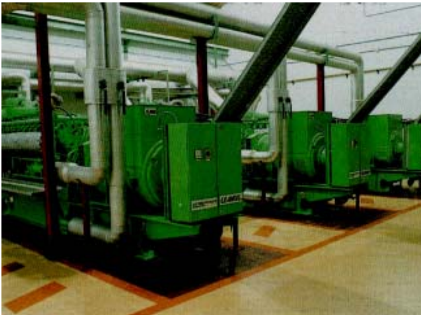
Abbildung 24: BHKW-Anlage in Modulbauweise (Quelle Jenbacher)
