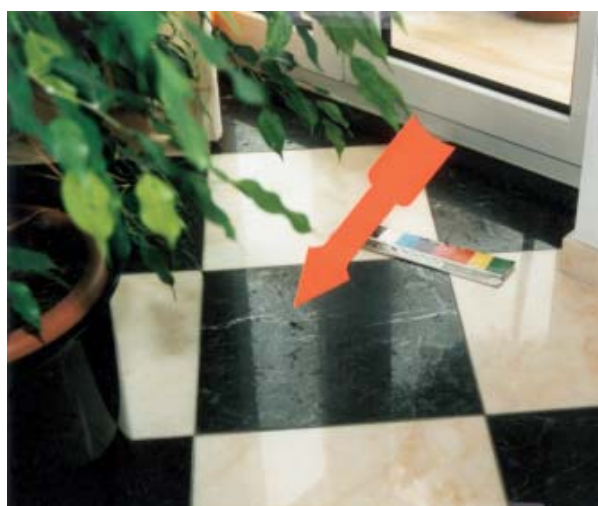
Im Gegenlicht deutlich zu erkennen: Abplatzungen an der Oberfläche der dunklen Platten
