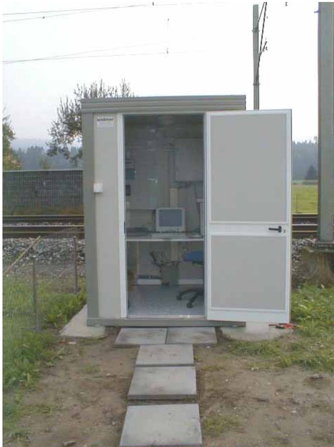
Klimatisierter Messcontainer mit PC und Steuerungselektronik
