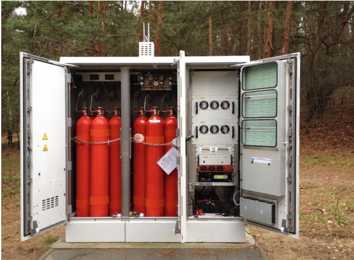
Abbildung 3-6: Beispiel für eine wasserstoffbetriebene BZ-USV
