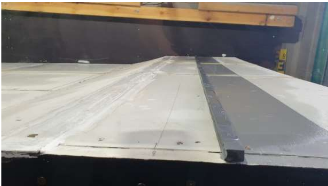
Abbildung 31: Seitenansicht – konkaver Wellenumlenker am Betriebsweg Profil D-West-West
