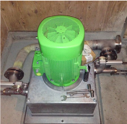
Turbine im Häuschen (noch ohne Druckleitung)
