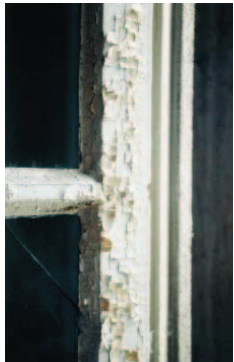
Abb. K: Der Anstrich löst sich großflächig vom Untergrund ab
