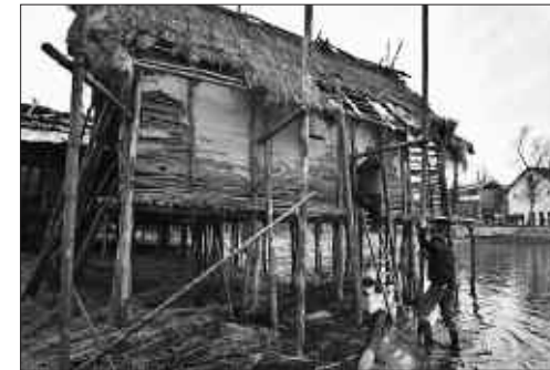
Abb. 1 (oben): Stark vom Sturm „Lothar“ und dem Hochwasser angegriffen, beginnt die Wiederinstandsetzung von Hornstaad- und Arbonhaus, Februar 2000.
