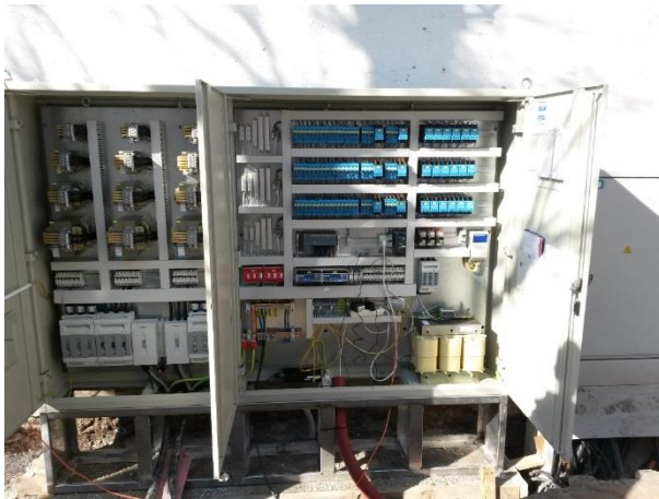
Abbildung 3.39: Montagephase des Reglers. Anordnung direkt neben dem KV.
