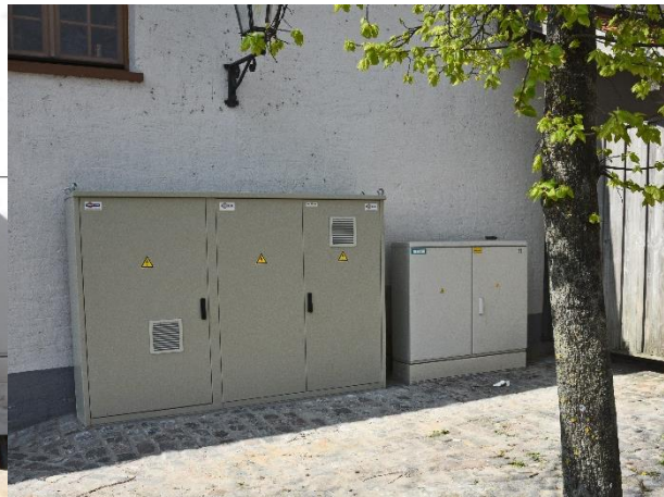
Abbildung 3.40: FLOW-R nach abgeschlossener Installation
