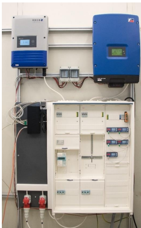
Abbildung 3.28: Wechselrichter der Hersteller SMA und KACO mit jeweils 9kVA
