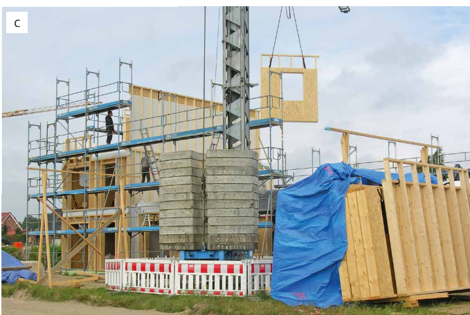
Abb. 6: Bauablauf für 1.000 m 2 Wohnfläche a) Abbund in der Werkstatt b) Montagetisch für die Herstellung der Wandelemente unter rollbarem Zeltdach c) Richten der ersten Häuser
