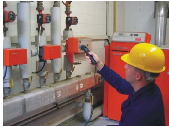
Überprüfen der Temperatur an Heizkreisen
