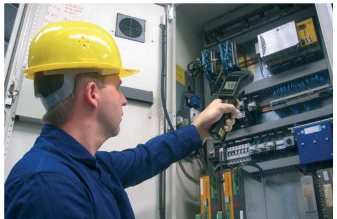
Detaillierte Infrarottemperaturmessung an einer elektrischen Steuerung mit Hilfe der eingebauten Scharfpunktoptik des optris LS LT im 1 Millimeterbereich
