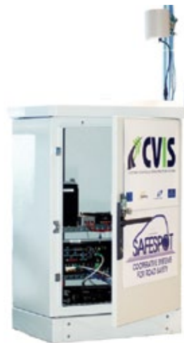
Beispiel einer CVIS-Road Side Unit. Quelle: CVIS
