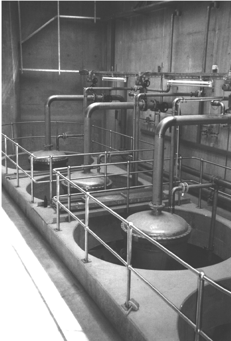
Kopfbereich einer vierstraßigen Vakuum-Entgasungsanlage
