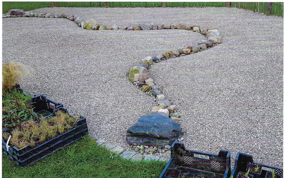
Vorbereitung der Fläche. Noch ist nichts von der späteren, wilden Schönheit zu erahnen.
