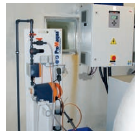
Dosierstation zur Zugabe von Natriumhypochlorit zur Notdesinfektion
