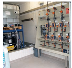
Dosierstation mit zwei doppelstöckigen Chemikaliensbehältern für Flockungsmittel
