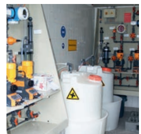
Dosierstation zur Dosierung von Natriumhypochlorit und Natriumbisulfit zur Desinfektion der Ultrafiltration
