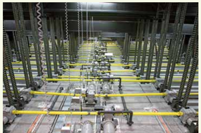
Untermaschinerie der Podien mit SERAPID-Schubkettenantrieb
