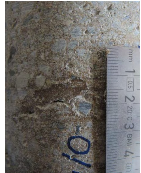
Poren an Betonierabschnittsgrenze 0,33 m
