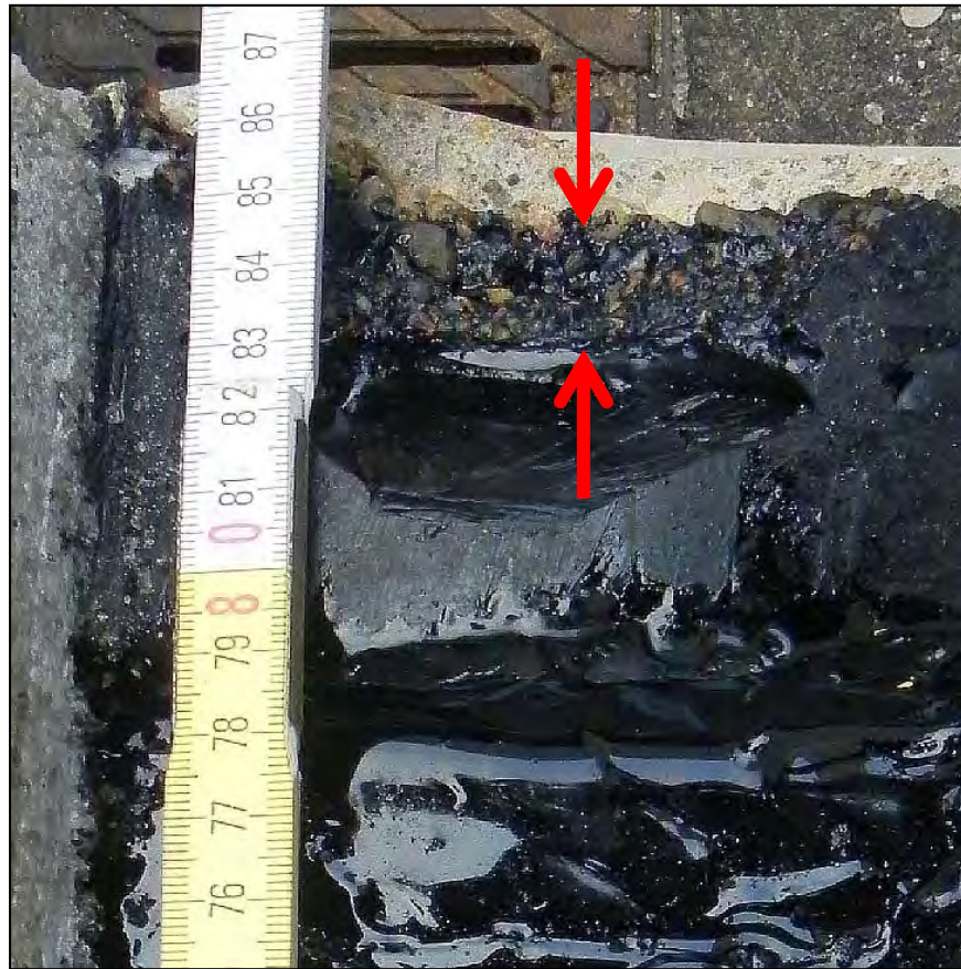
Penetration des Sperrbitumens in den Porenraum der Kontrollkammer
