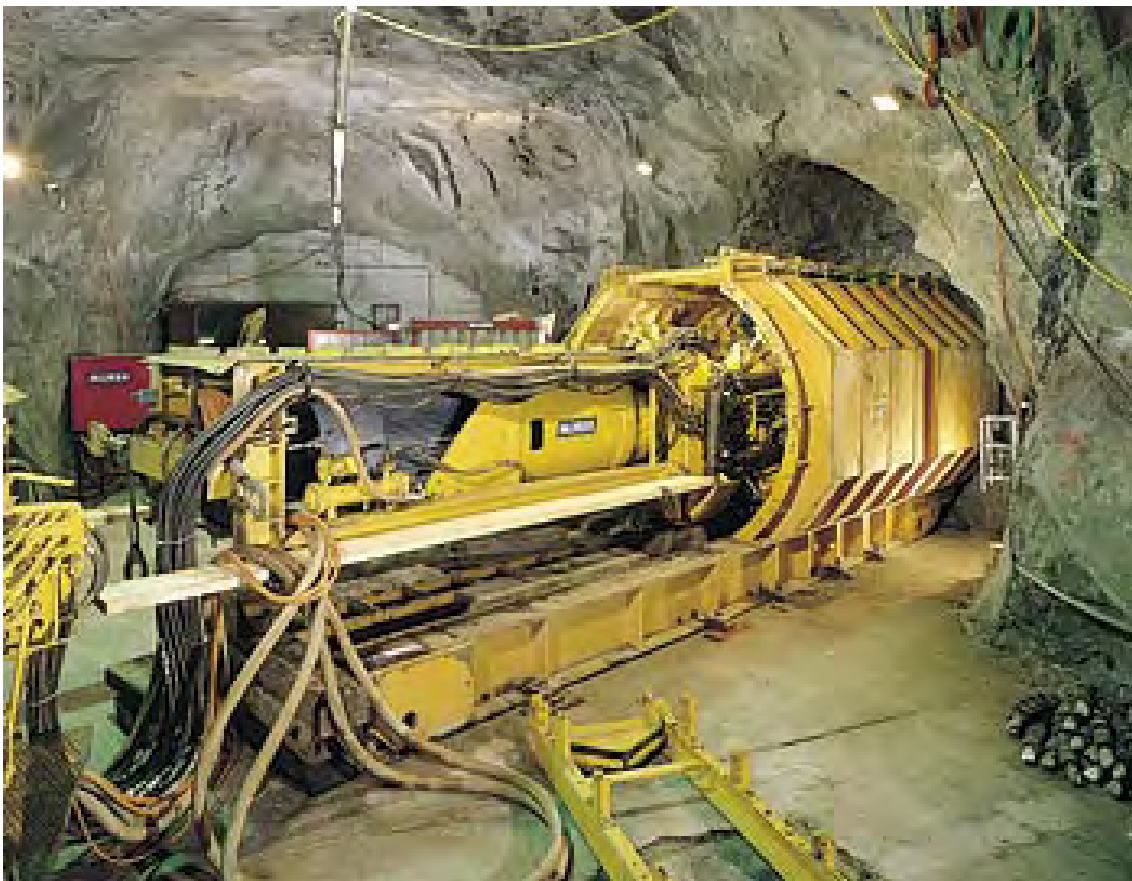
Abb. 8 Tunnelbohrmaschine für den FEBEX-Stollen (Durchmesser: 2,3 m) /NAG 08c/
