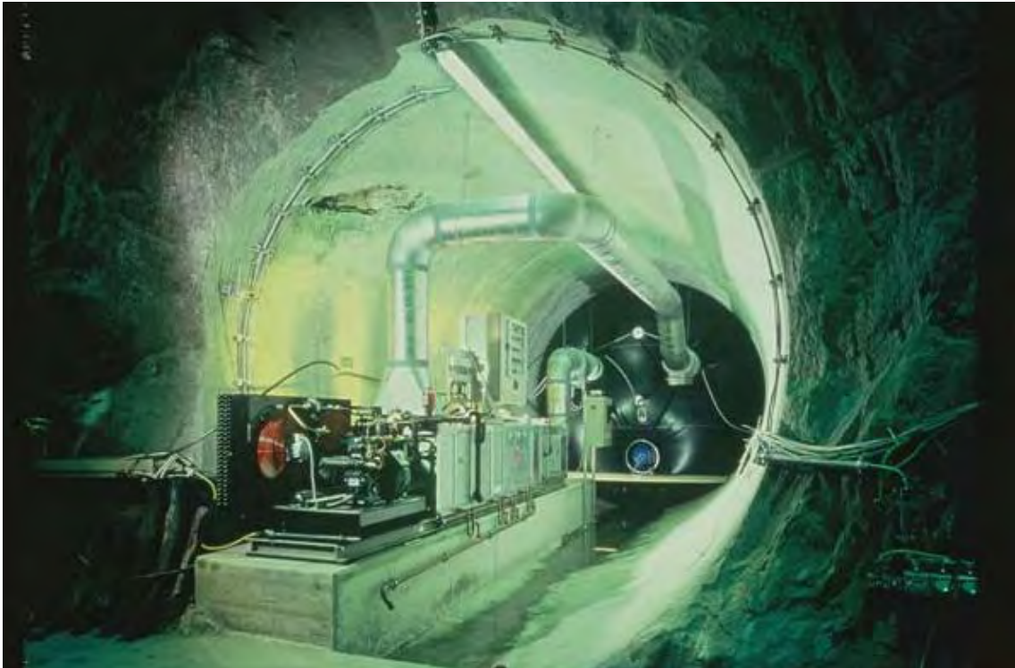
Abb. 6 Aufbau des Ventilationstests im Felslabor Grimsel zur Ermittlung des Gebirgsfeuchteintrags in einen abgedichteten Streckenabschnitt. Der eigentliche Messabschnitt ist durch ein Bergwerksskissen vom übrigen Stollensystem abgedichtet. Vorn die Klimaanlage zur Auskondensierung der im abgedichteten Streckenabschnitt aufgenommenen Feuchte
