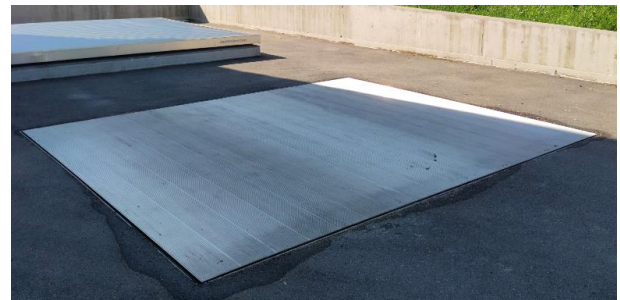
Bild 6.9 Silodeckel nicht befahrbar im Hintergrund und befahrbar im Vordergrund. Beide im geschlossenen Zustand. (Quelle: Schmid energy solutions).
