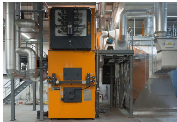
Bild 5.11 Automatische Kesselrohrreinigung (Quelle: Schmid energy solutions).
