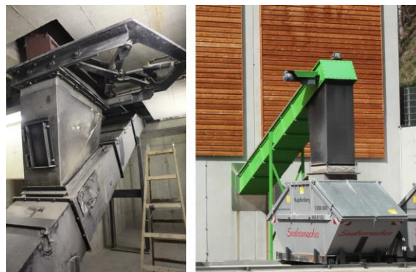
Bild 6.41 Mechanische Entaschungsfördereinrichtung: mit Kratzkettenförderer (Quelle: AEE IN-TEC).
