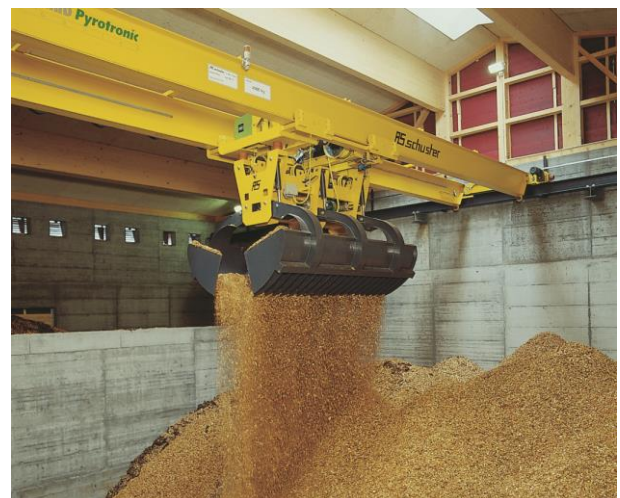
Bild 6.15 Vollautomatisches Kransystem mit Ablademulde und Tagessilo (Quelle: Schmid energy solutions).
