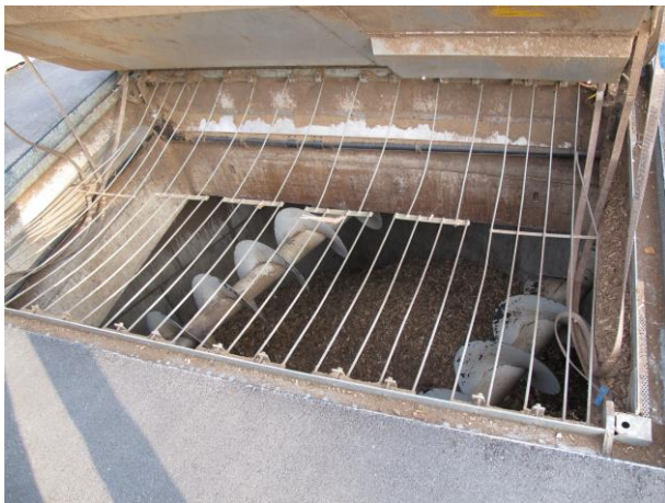
Bild 6.11 Befüllungsschnecken (Quelle: Holzenergie Schweiz).
