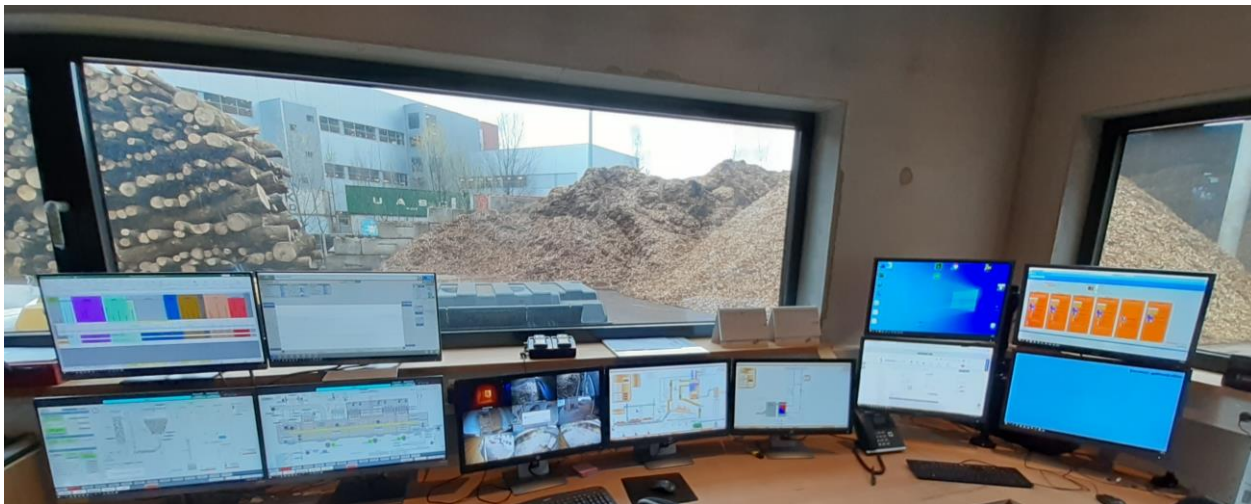
Bild 5.24 Leitwarte eines Holzheizkraftwerkes (Quelle: AEE INTEC).
