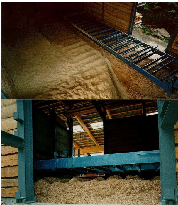
Bild 6.16 Be- und Entladesystem mit horizontal und vertikal verschiebbarem Kratzkettenförderer [68].
