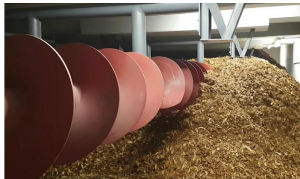
Bild 6.12 Siloverteiler (Quelle: Schmid energy solutions).
