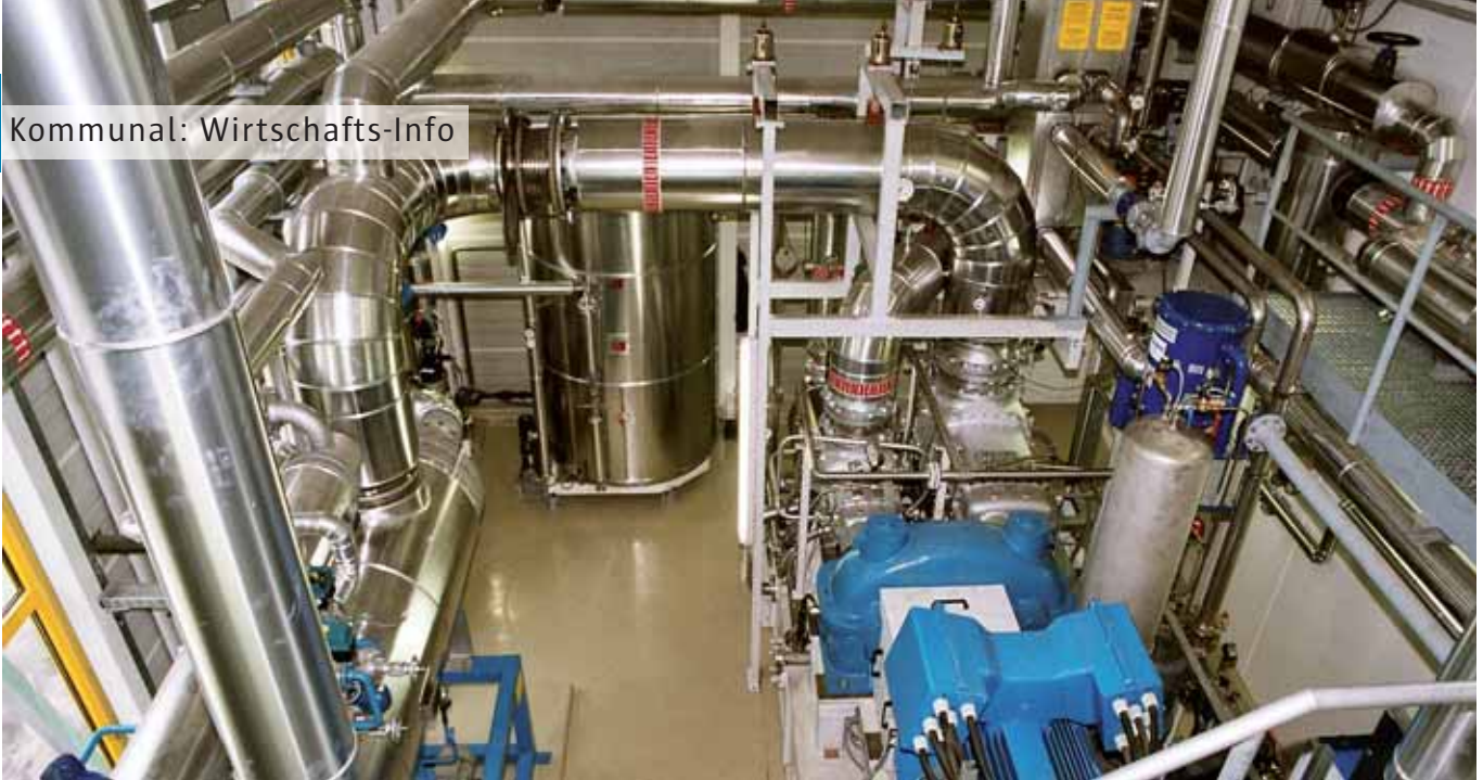
Das Dampfschrauben-Blockheizkraftwerk im Biomasseheizwerk Hartberg: Die komplexe Technologie hilft Gemeinden Kosten sparen.
