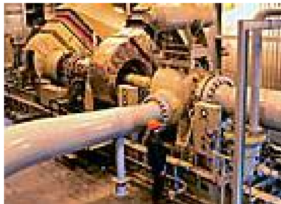
Abb. 7: Turboverdichter im Einsatz "Untergrund-Erdgasspeicherung"
