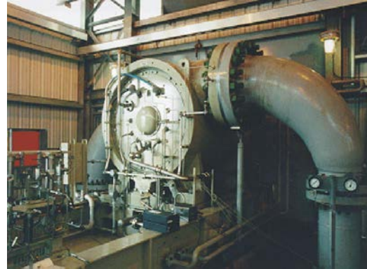
Abb.15: Typische Gasturbine als Antrieb für einen Turboverdichter
