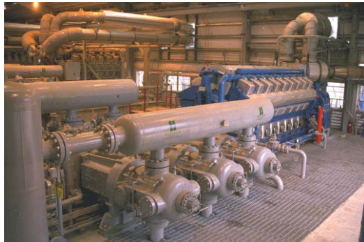
Abb.11: Kolbenverdichteranlage auf einem Untergrundgasspeicher (Moss Bluff / Texas / USA)
