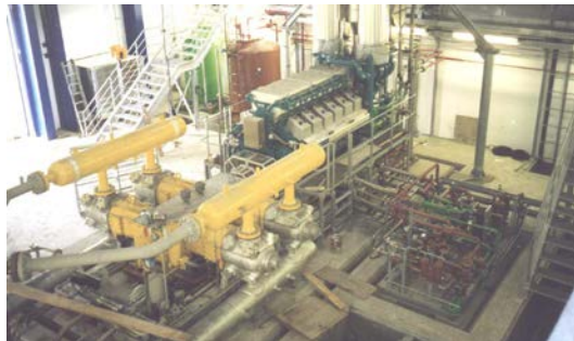
Abb. 4: Typische gasmotorisch getriebene Kolbenkompressorenanlage (Buchholz/D)
