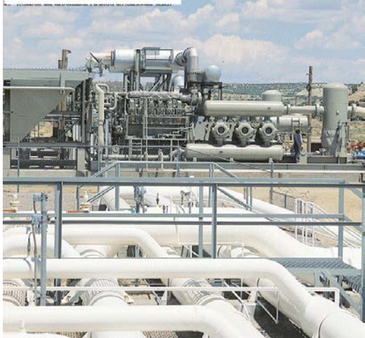
Abb.14: Kompressorenanlage auf einem Speicher in West-Texas
