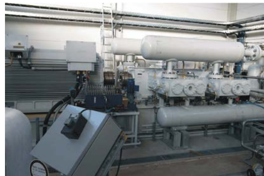
Abb. 16: Typische e-motorische angetriebene Kolbenkompressorenanlage (Kraak/D)
