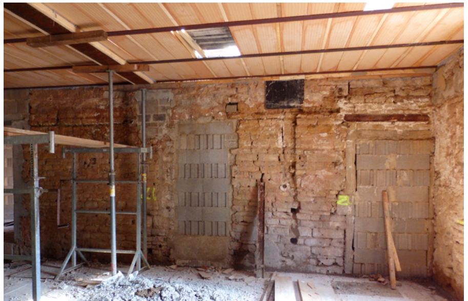
Abbildung 7: Unfallörtlichkeit mit durchbrochenen Ziegelplatten an der Erdgeschossdecke
