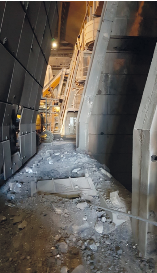
Abbildung 4: Vom Schutztor abgefangene Schlacke und Anlagenstücke
