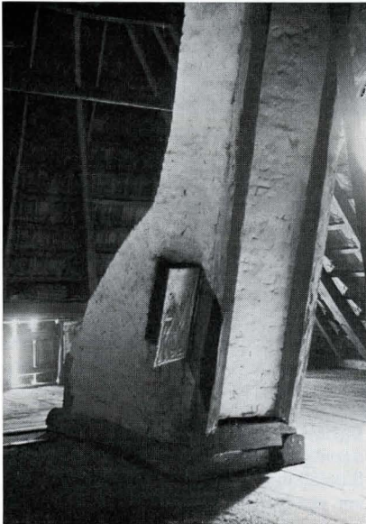
Bild 4. Brandgefährliche auf Holz aufgesattelte Schornsteinanlage älterer Bauart in einem Dachboden.
