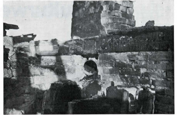
Bild 5. Der Gebäudebrand entstand durch eine feuergefährliche Rauchabzugsanlage. Das Rauchrohr war in fahrlässiger Weise zu nahe an einem Holzbalken in den Schornstein geführt worden.
