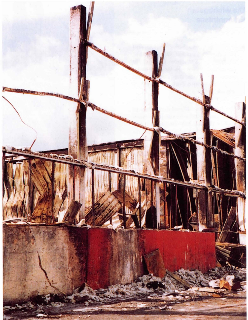
Bild 4: Die Reste der Halle an der süd-westlichen Ecke.
