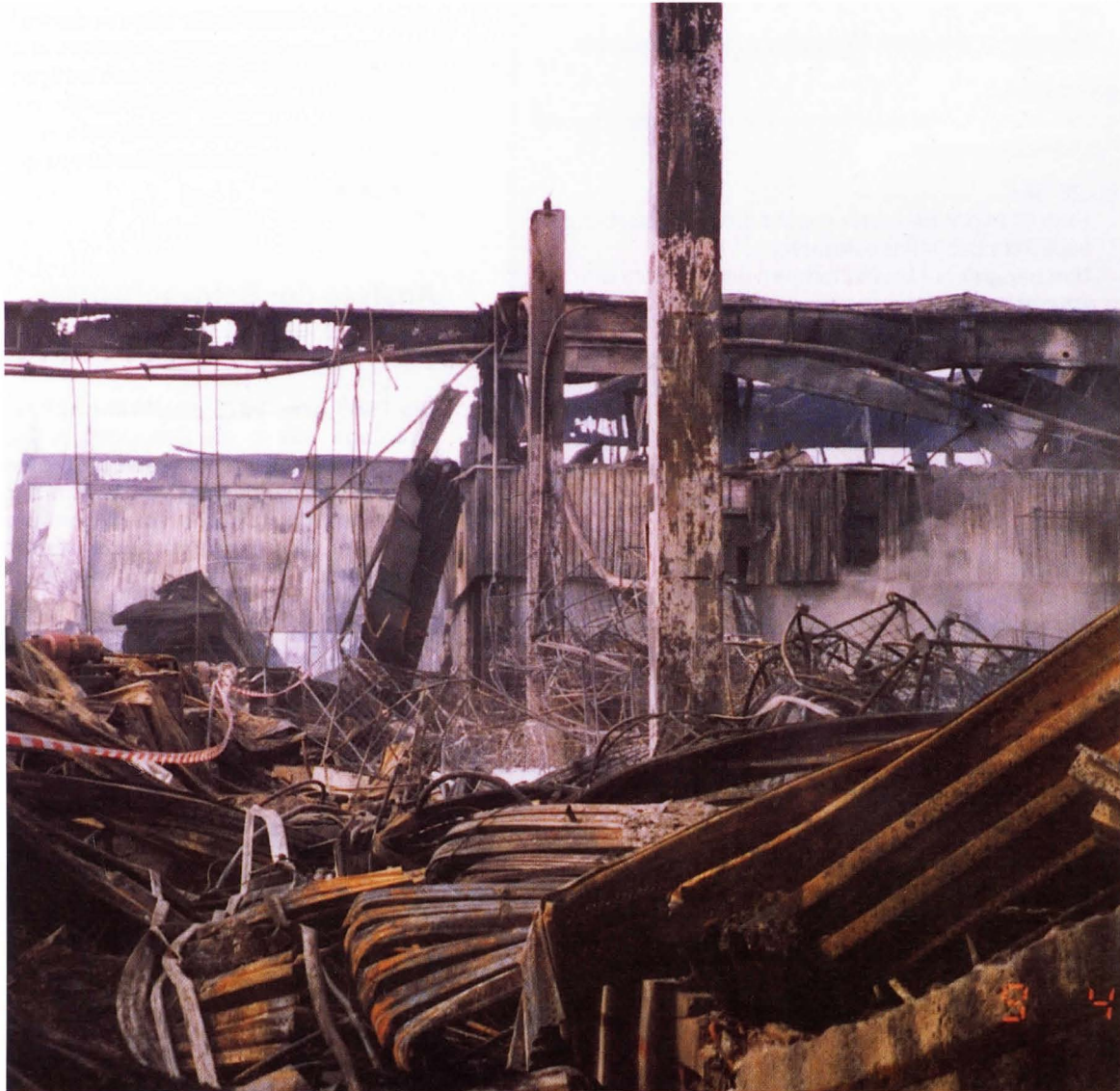
Bild 1: Der Blick auf den Schadenentstehungsort zeigt das Ausmaß der Zerstörung. Die noch vorhandenen Stahlbetonbinder sind durch die thermische Belastung regelrecht durchlöchert.
