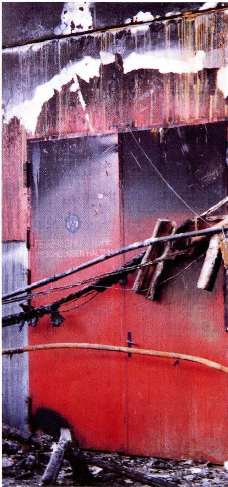
Bild 5: Der Feuerschutzabschluß (T 90) in der Trennwand zu den Technikräumen. Die Tür hielt der enormen Beanspruchung stand – die Wand wurde jedoch im Dachbereich überlaufen.
