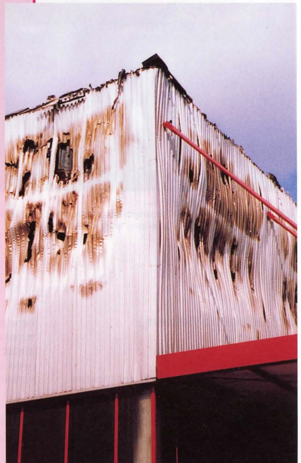
Bild 2: Das nordöstliche Gebäudeeck, rechts die Überdachung der Bahnrampe. Hier war es der Feuerwehr gelungen, eine Widerstandslinie aufzubauen und die angrenzende Bebauung (Traglufthalle) zu retten.
