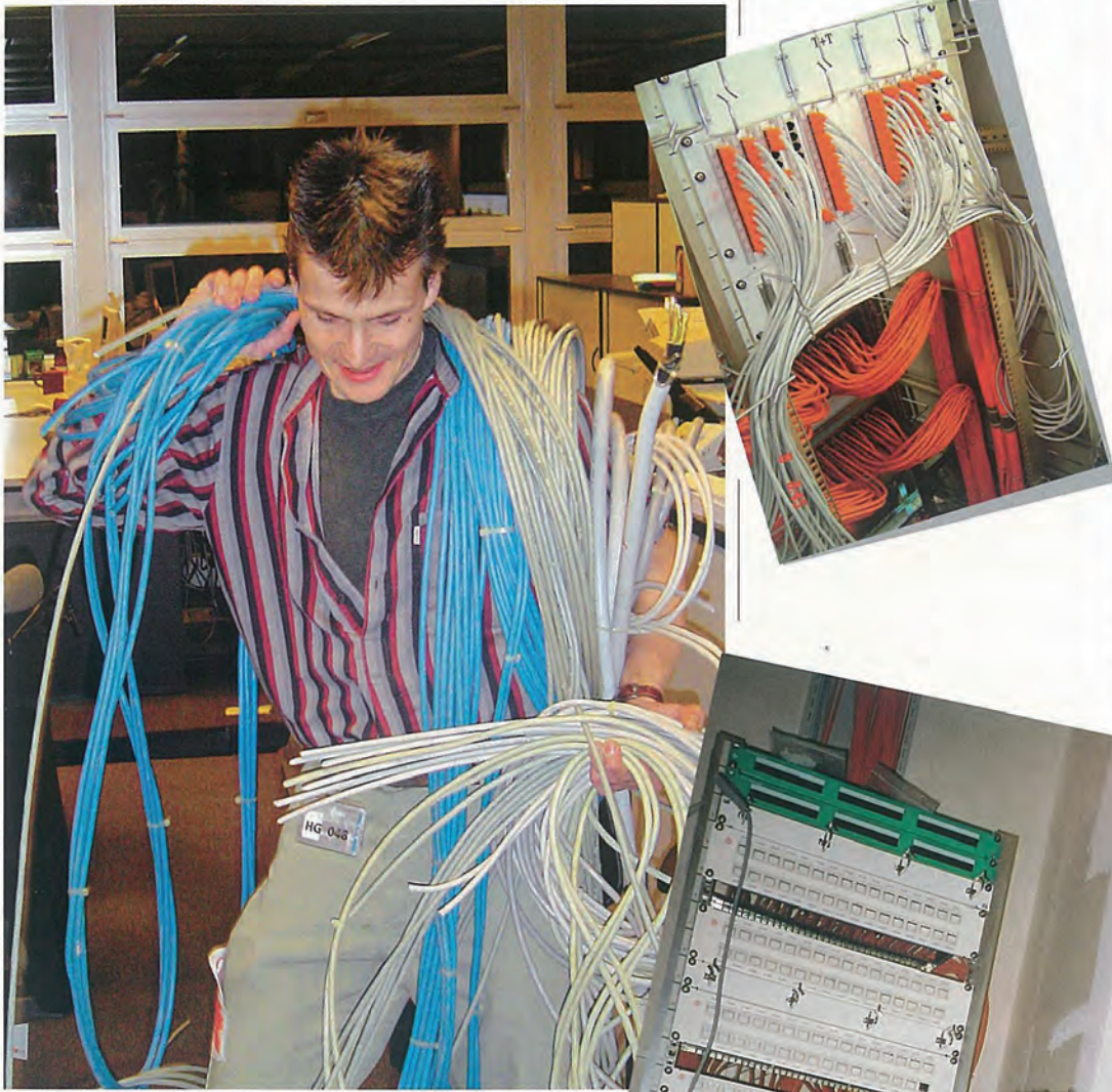
Andy Wyss demontiert wertvolles Kabelmaterial, damit wir noch wertvolleres neu einziehen können.
