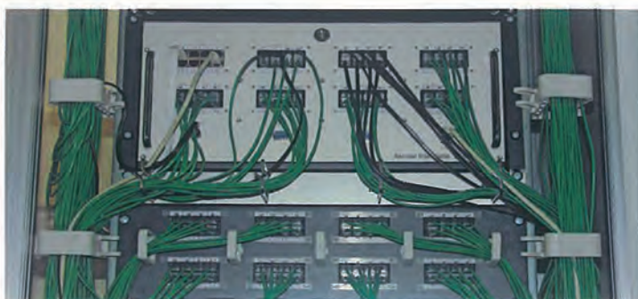
Ascotel Intelligate in 19" Bauform eingebettet im Rack
