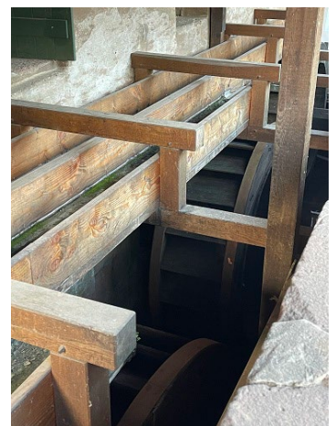
Das mittlere Wasserrad ist durch einen Holzpilz angegriffen und muss ersetzt werden. ©SG, Foto: Susanne Király
