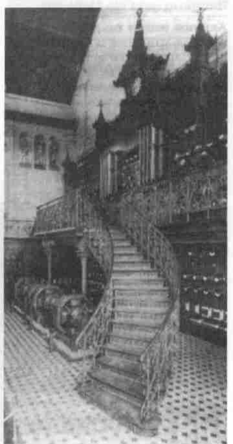
Fast sakral: Die Schaltwarte des ersten HEW-Neubaus nach ihrer Gründung im Kraftwerk an der Karolinenstraße.
