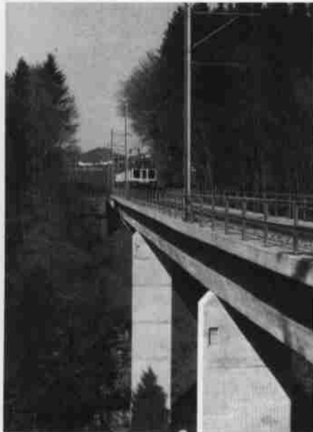
1973/74 wurde eine neue Kaubachbrücke erbaut; sie überquert in einer Höhe von 37 m das tiefe Tobel.
