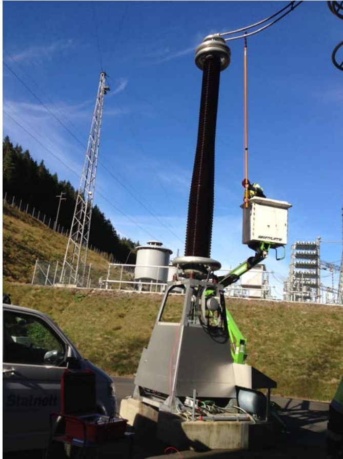
Fig. 4: Der Endverschluss, schon der Anschluss ist eine Herausforderung.
