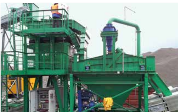
Semimobile Setzmaschinenanlage im Recyclingbereich
