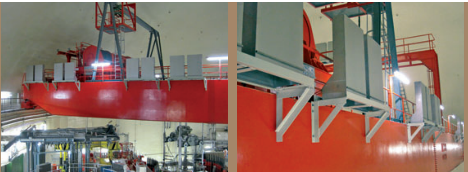
Einsatz des Wasserstoffabbausystems am Rundlaufkran im KKW
