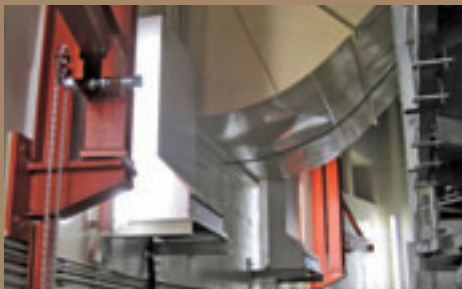
Verschiedenste Einsatzorte (v. o. n. u.) am Dampferzeuger, im Armaturenraum, im Rohrkanal
