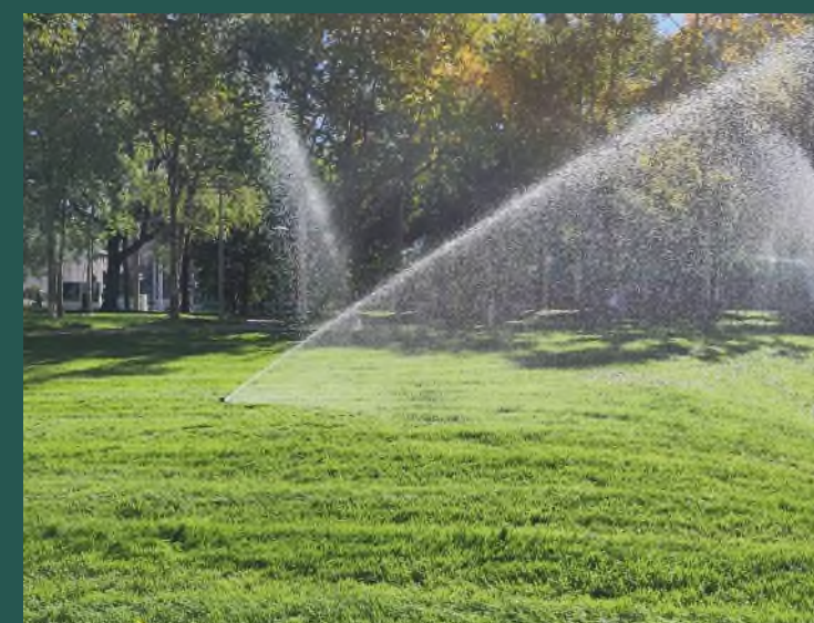
Mit einer fest installierten Bewässerung kann Wasser eingespart werden. Ein grosser Tank dient als Wasserspeicher.
