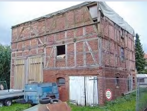
Festgestellte Schäden (oben) und Zustand nach durchgeführter Sicherungsmaßnahmen
