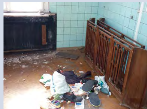
Das Innere des Gebäudes nach dem Brand Fotos: Landeshauptstadt Dresden
