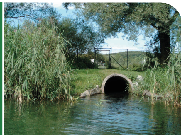
Einleitung des geklärten, sauberen Wassers in die Würm
