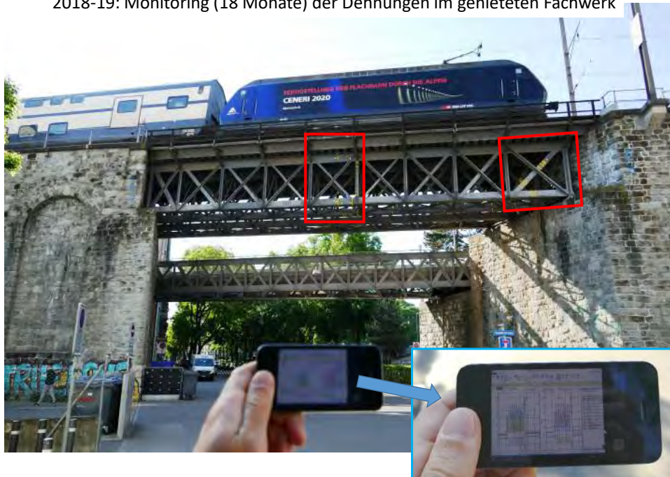
2018-19: Monitoring (18 Monate) der Dehnungen im genieteten Fachwerk
